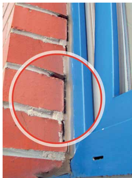
Dobře známé plísně v interiéru způsobené špatnou montáží
