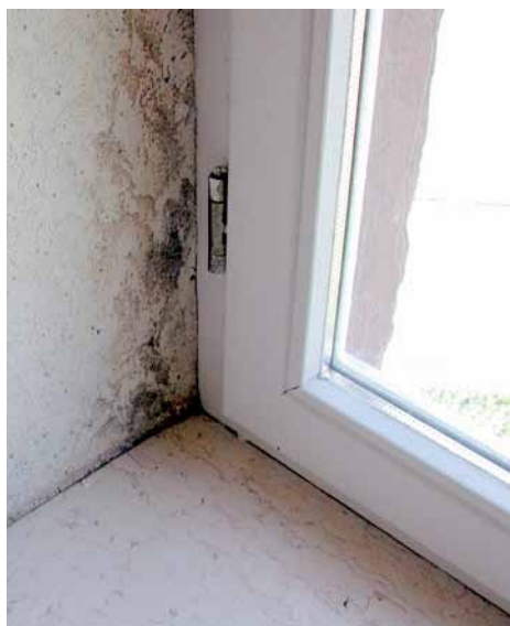
Netěsnosti a plíseň exteriérové – špatně vyřešené – okenní spáry
